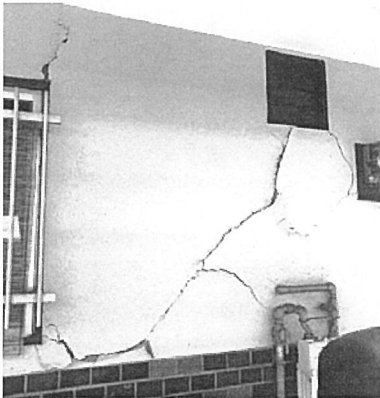
地震で被災した住宅の外壁
